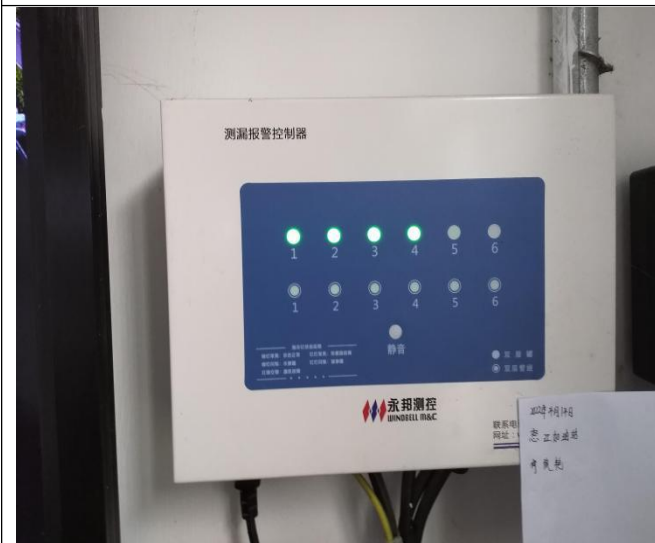
油罐渗漏检测
