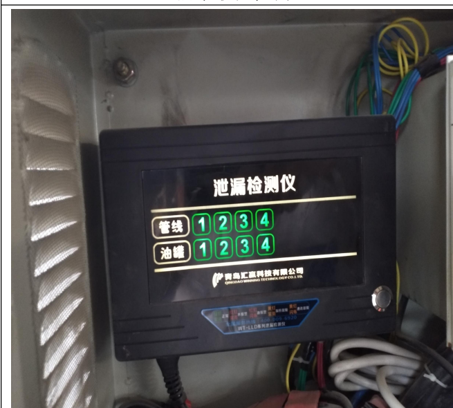
油罐渗漏检测
