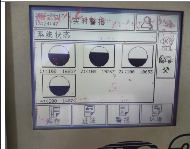
油罐液位检测
